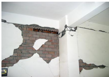
地震后柱端混凝土压碎
