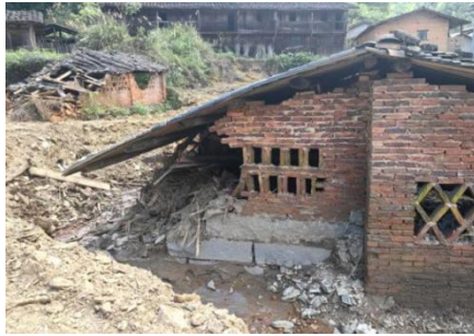
房屋部分倒塌
