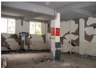
地震后填充墙产生斜裂缝或交叉裂缝
