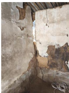
生土墙遭受水浸
