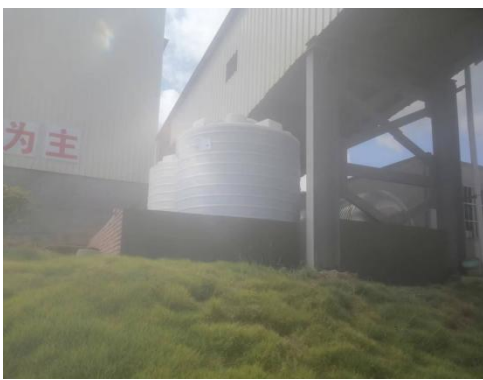
物料输送密闭皮带、储罐围堰
