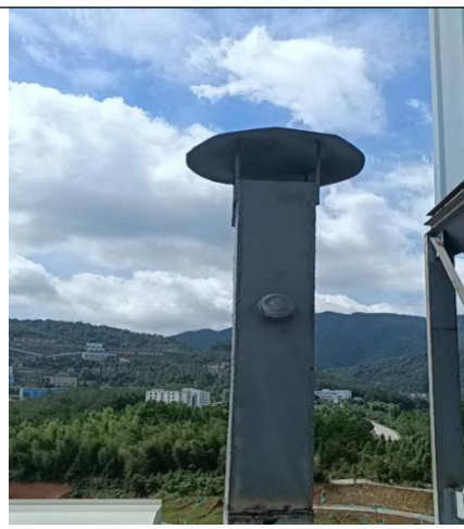
仓顶除尘器排气筒
