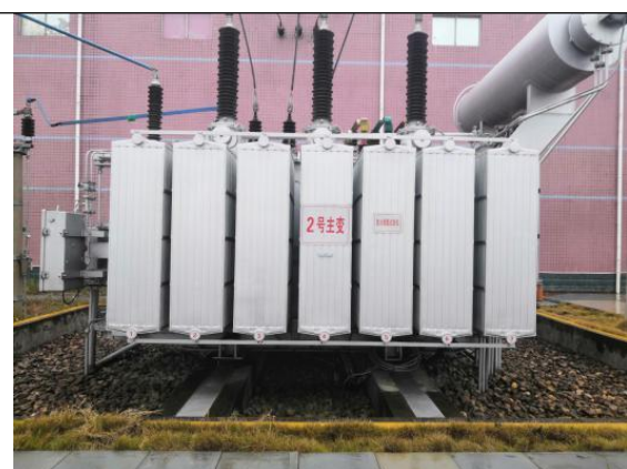
现有 2 号主变 (31.5MVA)
