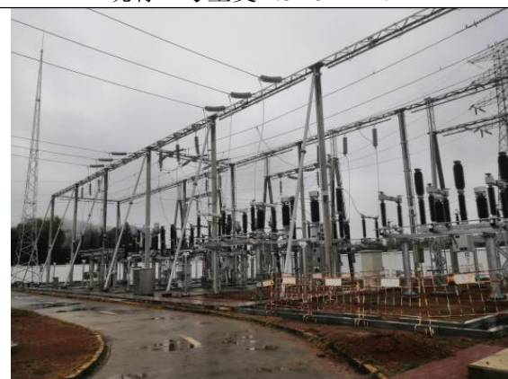
110kV 配电装置
