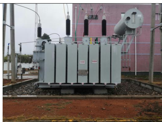
现有 3 号主变 (31.5MVA)
